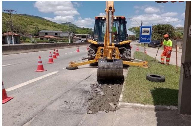
Figura 6.2 Via Lagos - Acostamento - Rep Superficial - KM 13+000 Sul
