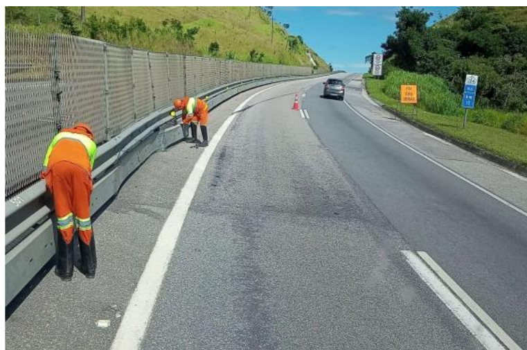
Figura 4.6 Via Lagos - Dispositivo de Segurança - Riel - Km 10+000 Sul
