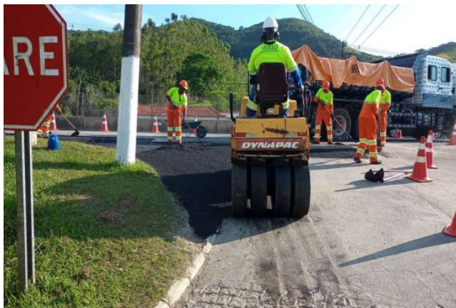
Figura 4.3 Via Lagos - Acostamento - Rep Superficial - KM 13+900 Sul
